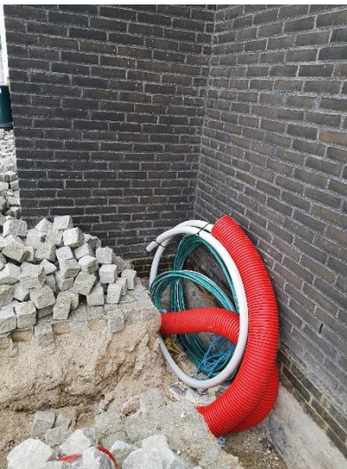
Elforsyningen afventer el-skab og tilslutning.
